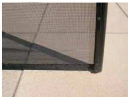
Bild 6. De rostfria stavarna måste vara helt inskjutna i förankringsbeslagen (säkerhetshakarna pekar i riktning poolen)
